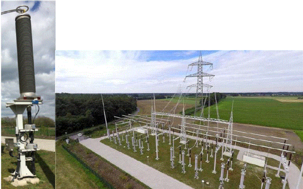
Abbildung 3-12: Kabelendverschluss und KÜS (Beispiel) (Quelle: Amprion)
