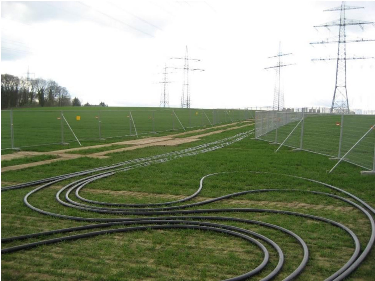
Abbildung 3-15: Darstellung Baueinsatzkabel (Quelle: Amprion)
