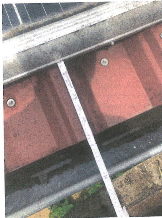
Abstand Photovoltaikanlage zur Dachrinne
