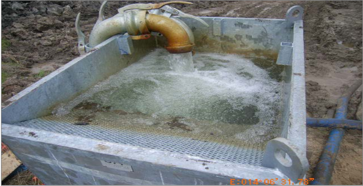
Abbildung 2: Beispiel eines Klär- und Absetzbeckens
