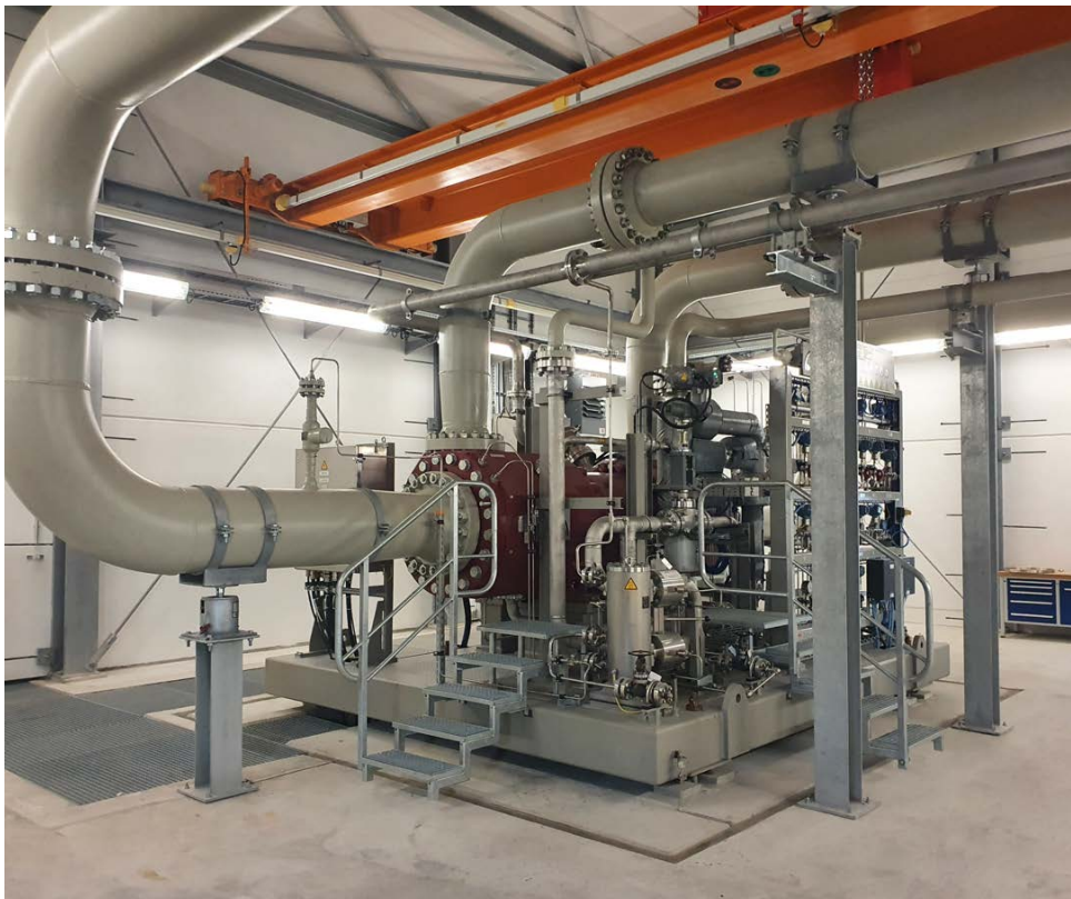
Abbildung 6: Beispiel einer Elektro-Verdichtereinheit innerhalb der Verdichterhalle
