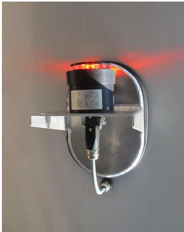
Figure 3-1: Tower AV light on the bracket
