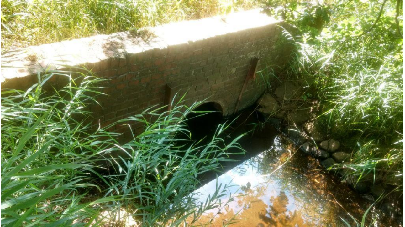
Foto 7: Durchlass der Otter mit Kopfbauwerk, nördliches Ende des Durchlasses.
