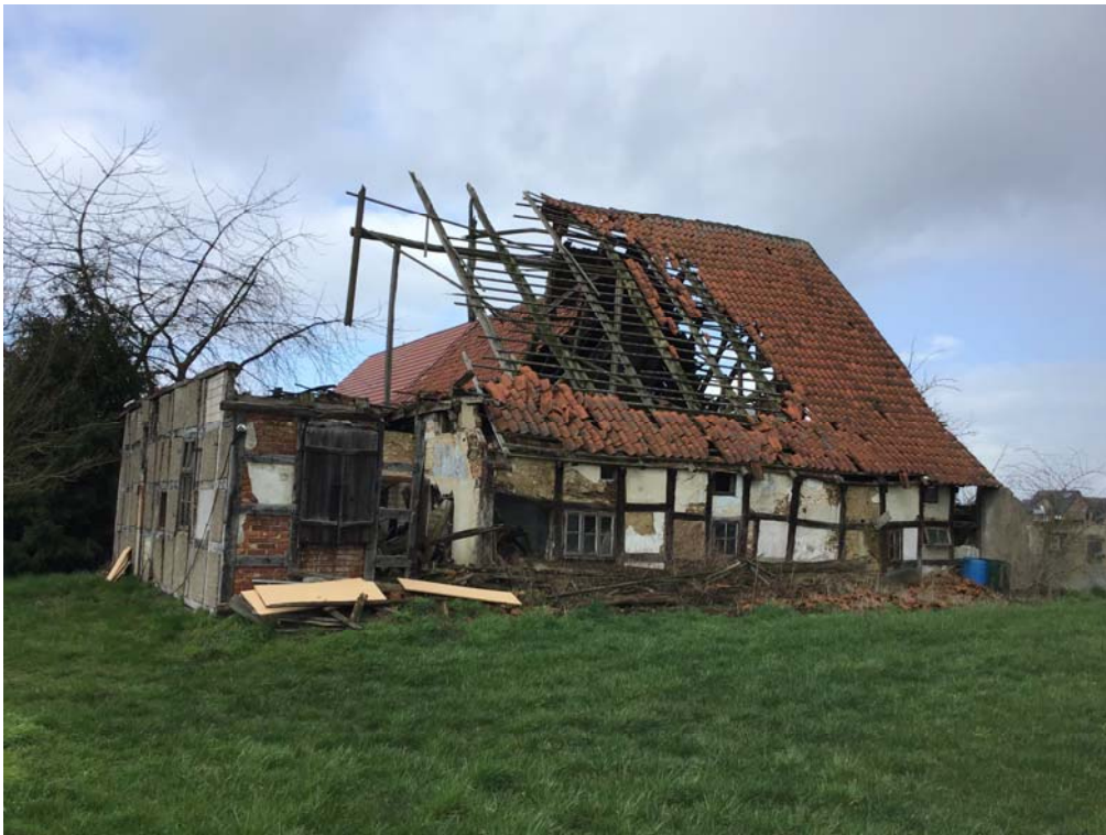
Foto 30: Blick auf die in Richtung Südosten ausgerichtete Hausfront des zerstörten und unbewohnten Wohnhauses W15
