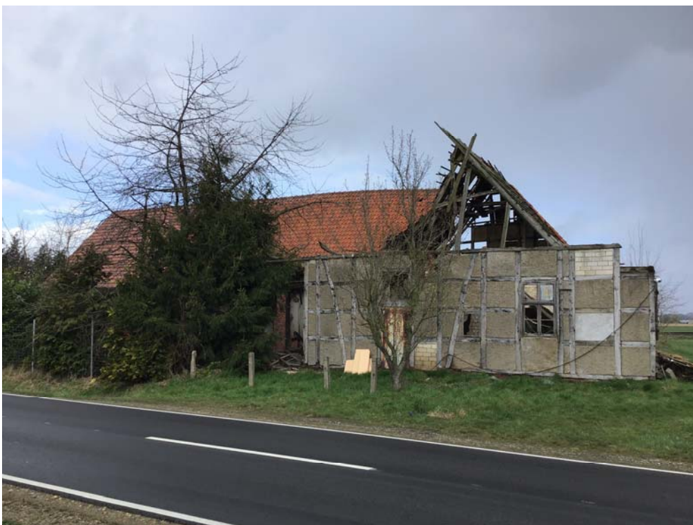
Foto 31: Blick auf die in Richtung Südwesten ausgerichtete Hausfront des zerstörten und unbewohnten Wohnhauses W15
