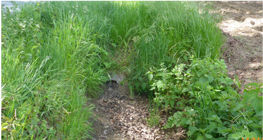
Abbildung 28: vollständig verlandete Rohrleitung
