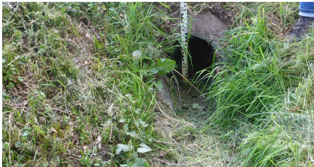
Abbildung 46: Rohrausmündung DN300 des Straßengrabens unter Feldüberfahrt kurz vor Mündung in den namenlosen Graben
