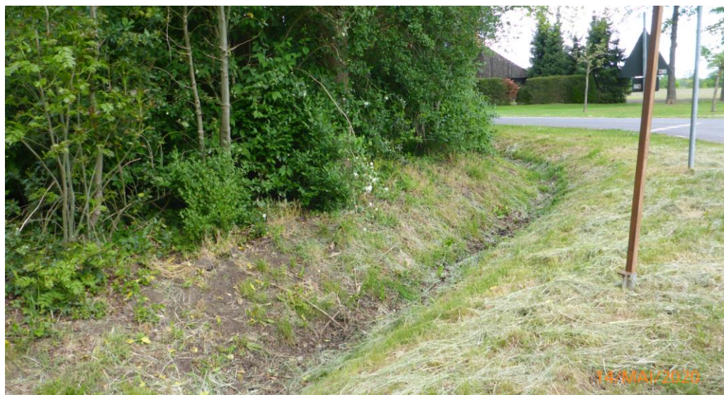
Abbildung 17: Situation bei Ende Bauabschnitt 1 in Halle (Graben/Mulde schließt an namenlosen Entwässerungsgraben aus Abbildung 16 an)
