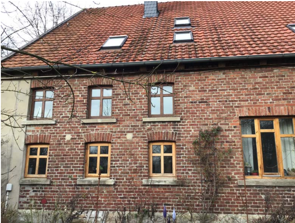
Foto 9: Blick auf die in Richtung Südosten ausgerichtete Hausfront (westlicher Teil) des Wohnhauses W05
