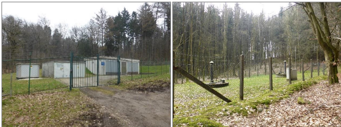
Abb. 7 Brunnenstandort „Limberg III“ (links) sowie Brunnenstandort „Limberg II“ (rechts)
