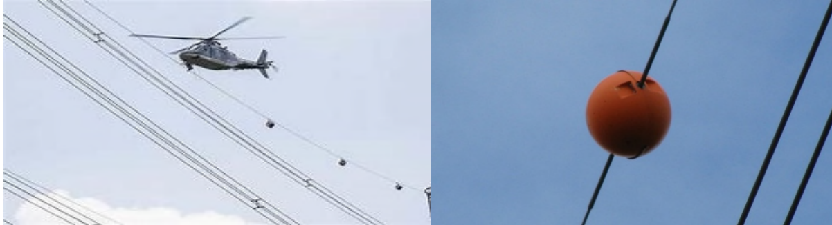
Abbildung 13: Montage von Flugwarnkugeln (Quelle: Mainpost, 10.11.2020) und Flugwarnkugel Fa. Pfisterer auf Erdseil
