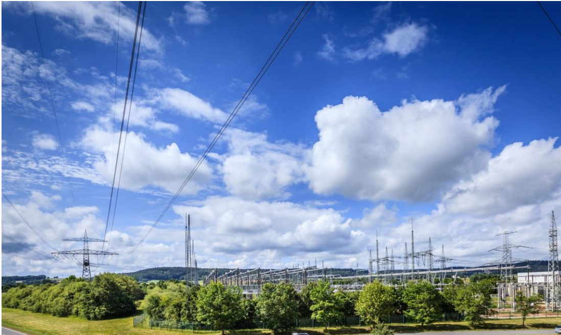
Abb. 15: Eingrünung eines Umspannwerks bzw. einer Schaltanlage
