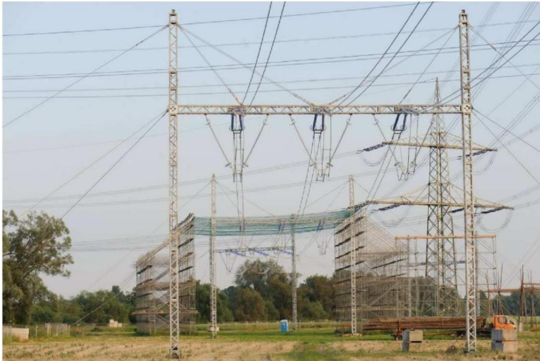
Abb. 12: Einsatz von Provisorien (380-kV-Freileitungsprovisorium für ein System, mit errichtetem Schutzgerüst im Hintergrund)
