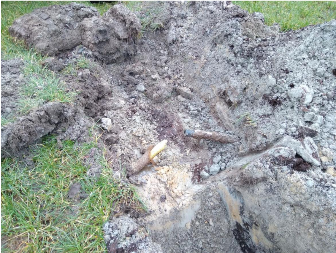
Foto 20: Kompensationsfläche A – Flurstück 68/7 – Durchtrenntes Drainagerohr (H&M 09.03.2023)
