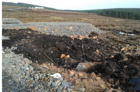
Abbildung 27: Beispiel für einen inakzeptablen/unvorbereiteten Arbeitsbereich
