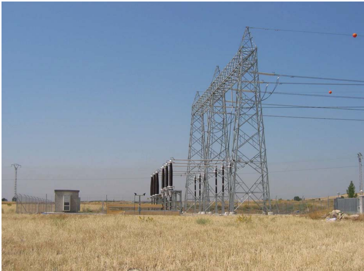
Bild 3.2 Übergangsanlage Kabel–Freileitung: Gesamtansicht (von rechts nach links) mit Abspannportal, Überspannungsableitern, Kabelendverschlüssen, Gebäude und umzäuntes Grundstück
