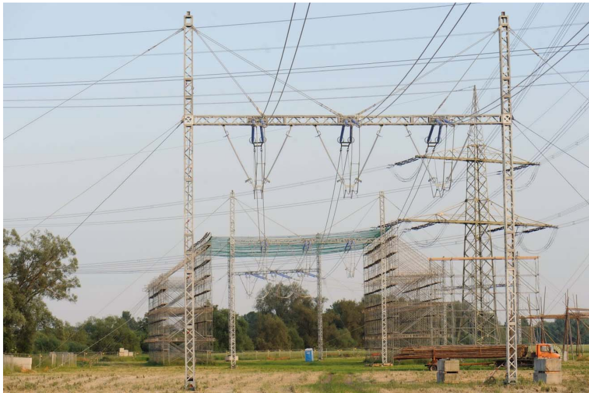
Abbildung 19: 380-kV-Freileitungsprovisorium für ein System, mit errichtetem Schutzgerüst
