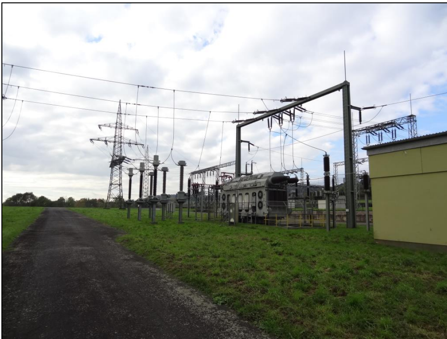
Abb. 3 Vorhandenen Transformator (Foto 2 in Anlage 1)
