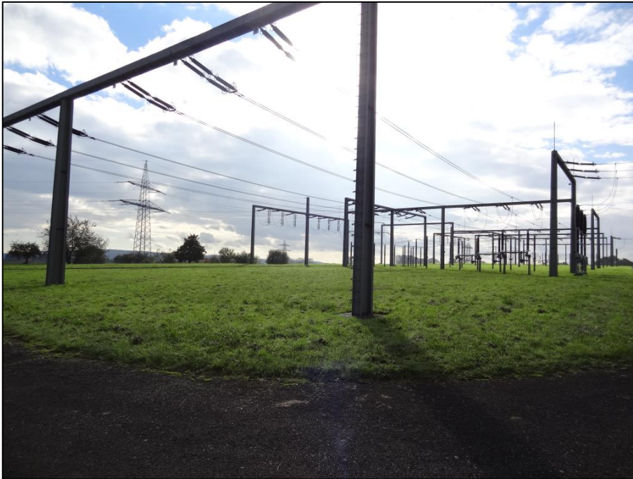
Abb. 4 Schaltfelder und Portale (Foto 3 in Anlage 1)
