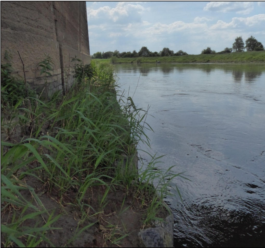
Abb. A1-10: Aller, Probestelle 3, Brückenpfeiler, Flusseite, 15.5.2018.
