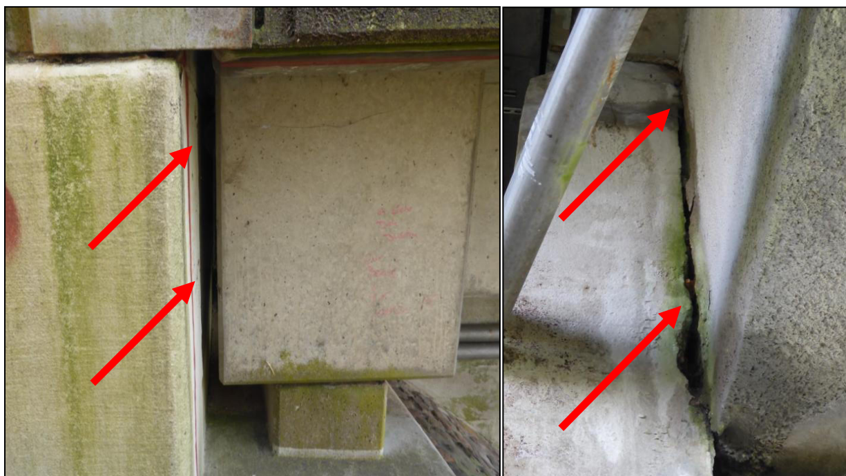
Abb. 3-2: Spaltenquartiere an der Brücke im Widerlager und Riss an Stützpfiler zum Brückenkörper (ID 04).
