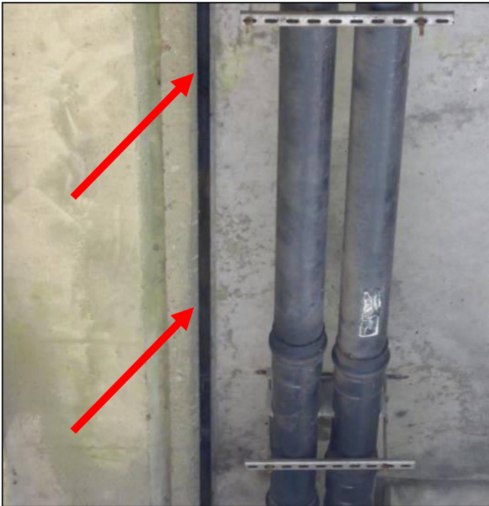
Abb. 3-3: Spaltenquartiere (Dehnungsfuge) in der gesamten Nordseite der Brücke.
