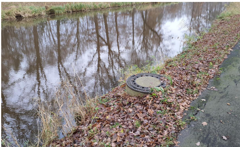
Abbildung 22: Schacht bei 30+875, Untergrund teils gemauert
