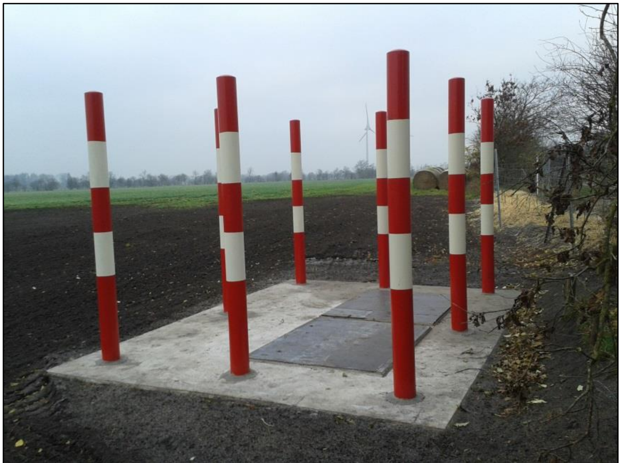
Abbildung 23: Abdeckung eines Doppelschachtes mit Anfahrtsschutz (Quelle: TenneT)
