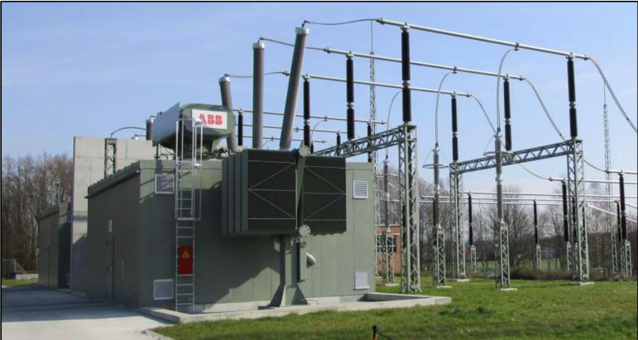
Abbildung 25: Zwei 380-kV-Kompensationsdrosselspulen mit Brandschutzwand (Quelle: TenneT)
