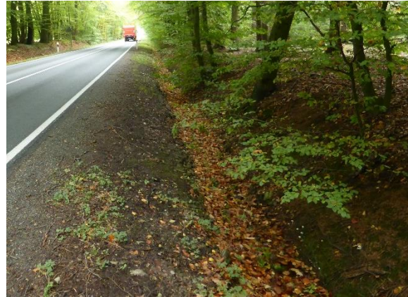
Abb. 7 Trockengefallener Straßenseiten-graben (Blickrichtung: Nord)
