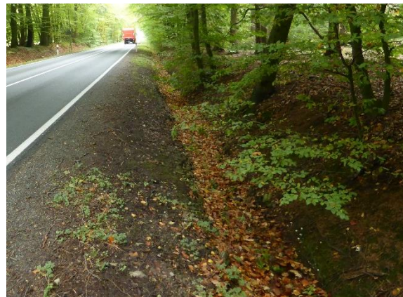
Abb. 13 Trockengefallener Straßenseiten-graben (Blickrichtung: Nord)
