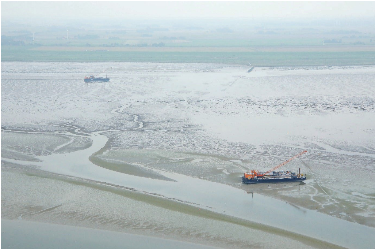
Abbildung 14: Luftbild einer exemplarischen Wasserbaustelle bei Hilgenriedersiel mit dem Arbeitsponton am Bohraustrittspunkt im Hintergrund und dem Anlege- und Fährponton am Riffgat-Fahrwasser im Vordergrund (Quelle: Tennet).
